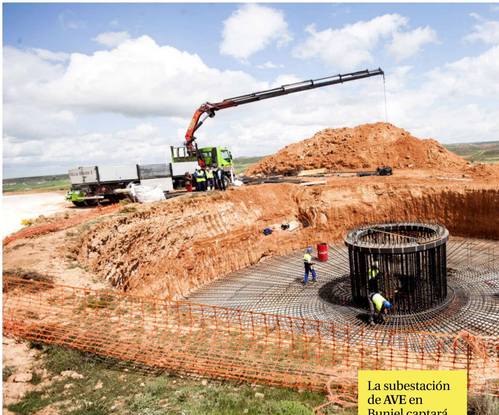
Obras de construcción del parque eólico de Los Ausines y Modúbar de San Cibrián hace tres años. / PATRICIA
